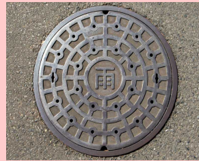
マンホールの蓋
